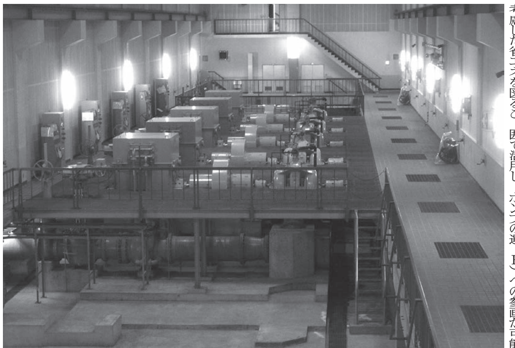
広島県水道広域連合企業団との共同施設である高陽取水場の取水ポンプ
