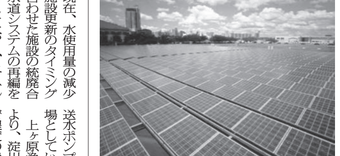
太陽光発電設備(柴島浄水場)
